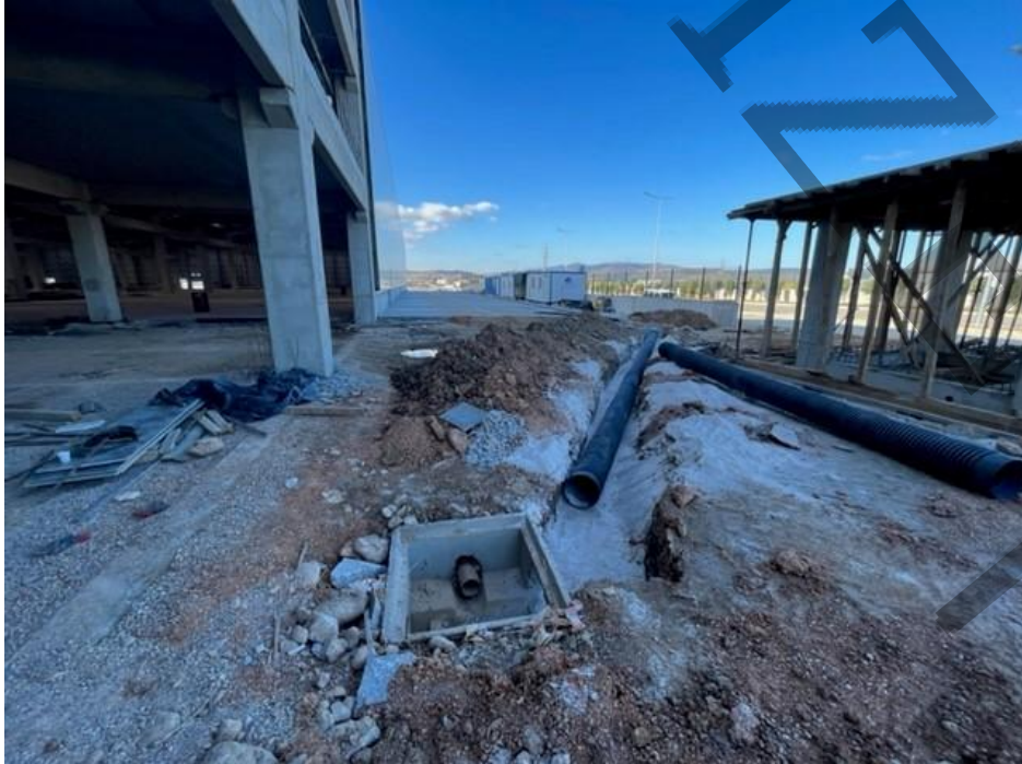
Resim-8 İdari Bina Pis Su Hattı
