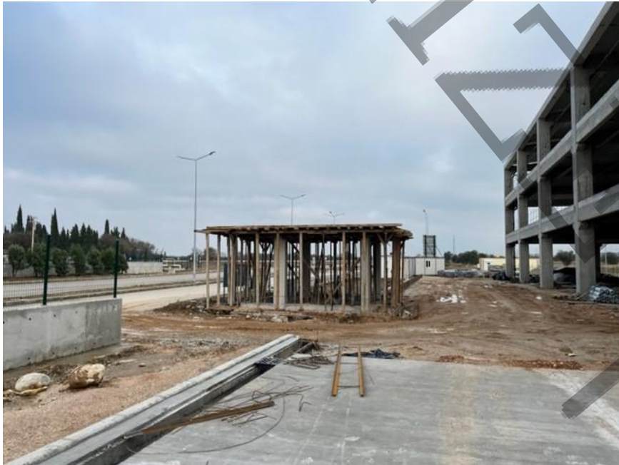
Resim-11 Eksik Yangın Geçişleri
