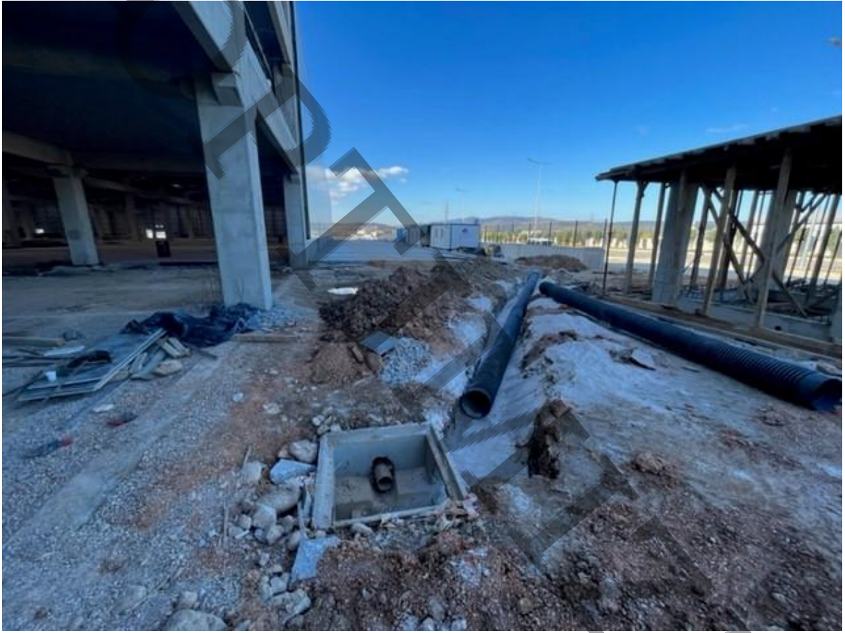
Resim-1 Eksik Zemin Betonları
